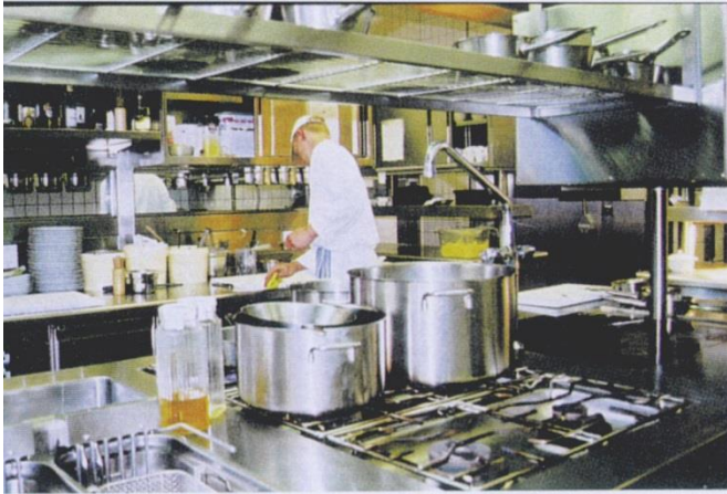
Kurze Wege und übersichtliche Postenaufteilung in der Küche.
